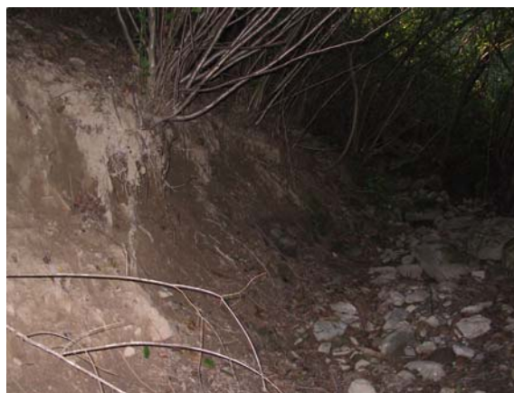
Foto 6: sponde in erosione lungo il canale BG073-023.
