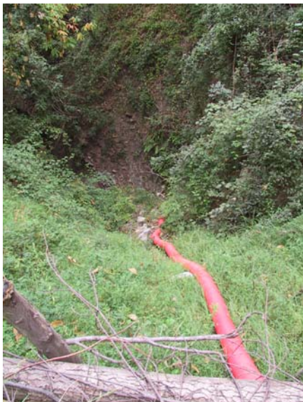
Foto 1: dissesto in atto sul canale BG073-029
