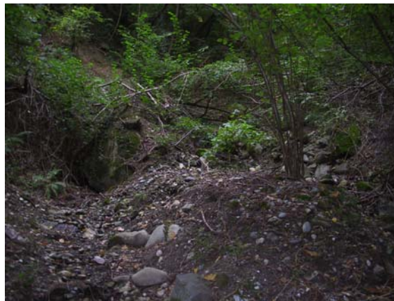
Foto 2: dissesto e accumulo di detrito in corrispondenza dell'attraversamento stradale, canale BG073-031.
